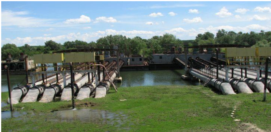
Stație de pompare a apei în lunca Prutului
